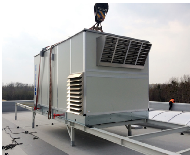
AIRSTREAM geïnstalleerd in Polen.
