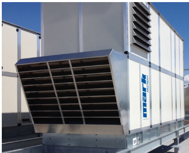
Luchtaanzuigkap op de unit.
