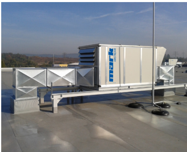
Buitenopstelling AIRSTREAM unit.
